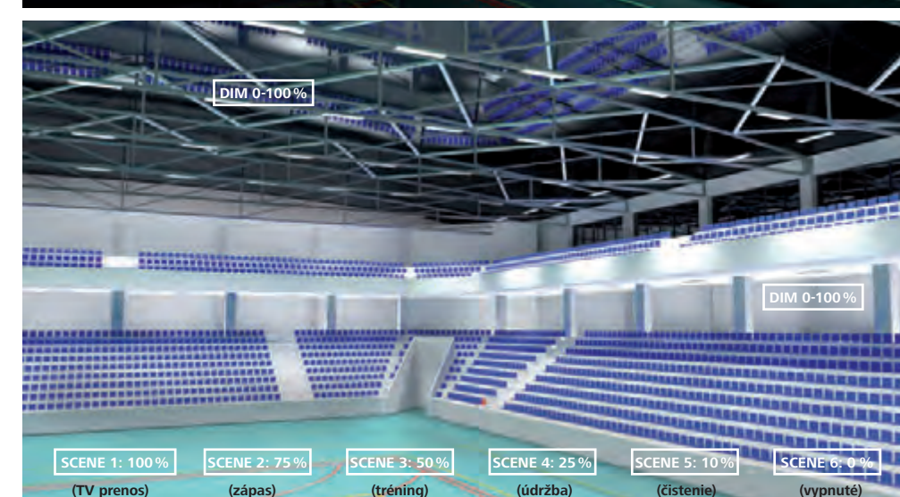
DALI osvetľovacia sústava umožňuje prednastaviť a vyvolať svetelné scény, teda preddefinovať požadovanú intenzitu osvetlenia na vybraný priestor v rámci celej haly. Každé jedno svetidlo sa dá v rámci svetelnej scény nastaviť na akúkoľvek úroveň (v rámci možnosti zotmenia) svetelného toku. Tieto svetelné scény sa dajú následne jednoducho vyvolať cez ovládacie tlačidlá alebo počítačovou aplikáciu.
