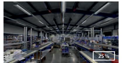
Upratovanie: 25% – svetelný tok 149lx – intenzita osvetlenia 1692W – aktuálna spotreba elektrickej energie
