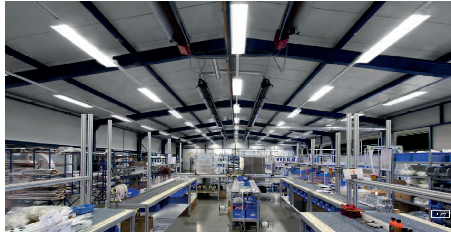
Denná zmena: Svietidlá osvetľujú celý priestor výroby. 100% – svetelný tok 500lx – intenzita osvetlenia 4700W – aktuálna spotreba elektrickej energie
